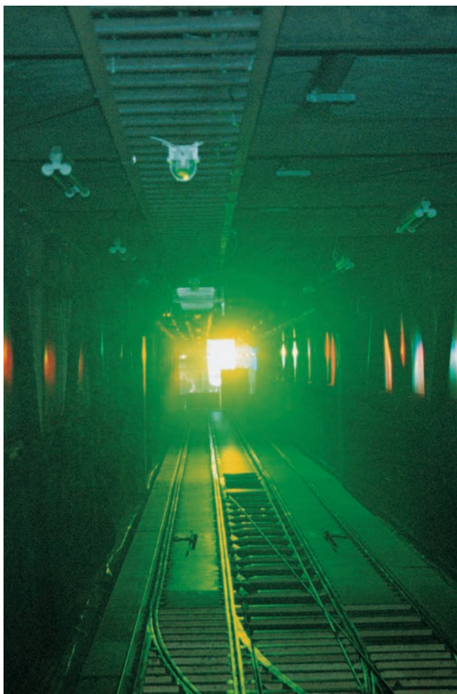
Oberer Bereich der doppelten Abt'schen Weiche ohne bewegliche Teile mit Blick zur Bergstation in der gleissenden Lichtinstallation von Peter Erskin.
