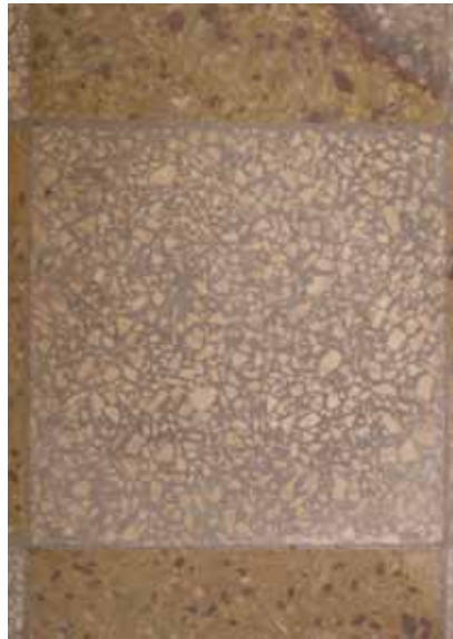
▼ Terrakotta-Fliesen im Warmluftraum der russisch-römischen Sauna
