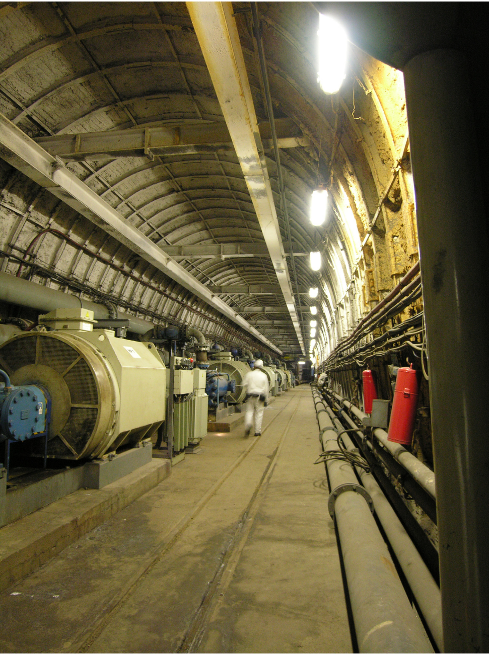
Pumpenkammer auf Sohle 14 südliche Blickrichtung
