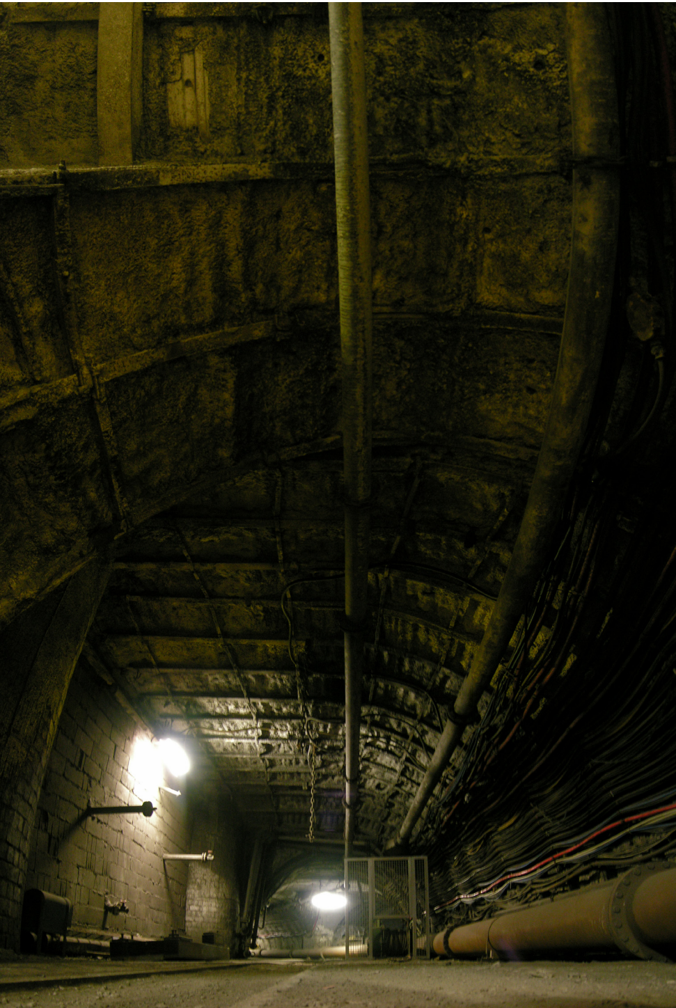
Am Anfang der Strecke, Richtung Osten, kurz vor der Pumpe
