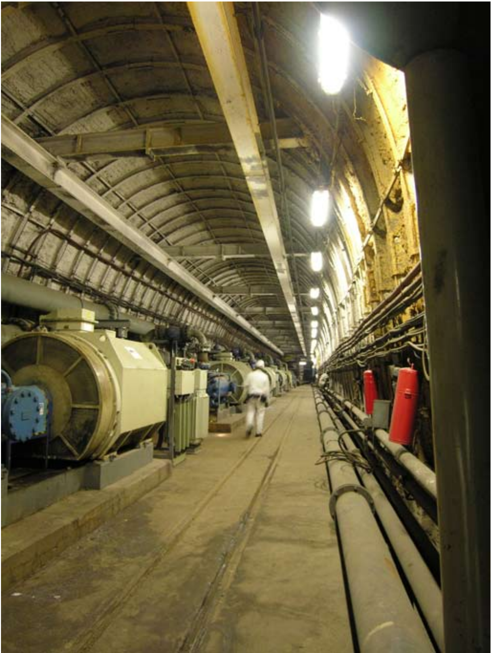
1.5.6 Pumpenkammer auf Sohle 14 südliche Blickrichtung
