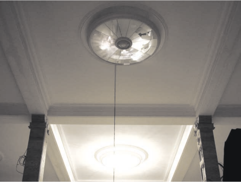
Lichtbemusterung im Obergeschoss des Berliner Zeughauses. Vorne adaptierte Rosettenleuchte, hinten bauseits vorgeschlagene Variante. Aufnahme: 28. Januar 2002
