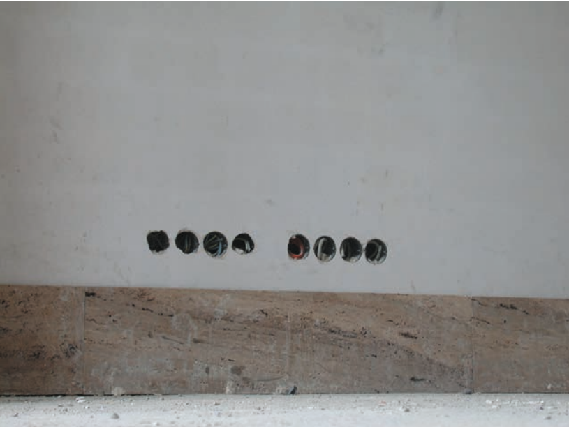
Steckdosenauslass an der Südwand des Treppenturms NW, 1. OG Aufnahme: 3. Juli 2002
